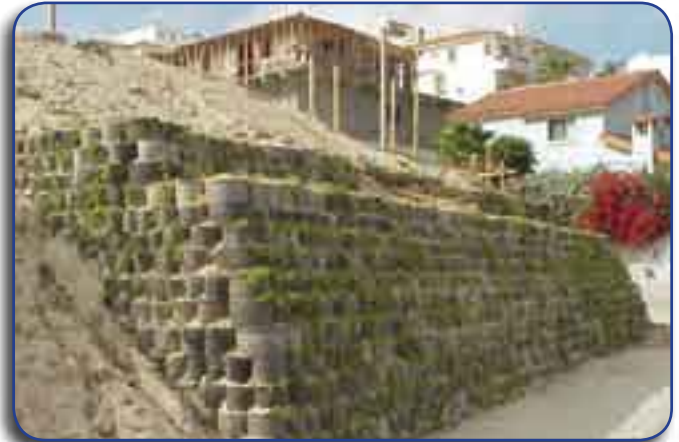
Whole tire wall used to impede soil erosion Photo courtesy of La Comisión Estatal de Servicios Públicos de Tecate
