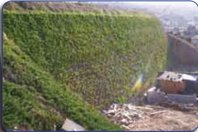
Sample retaining wall using whole tires Photo courtesy of La Comisión Estatal de Servicios Públicos de Tecate
